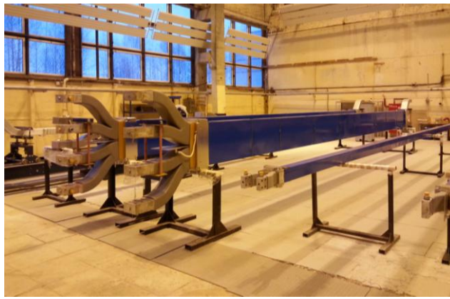
Рис.3. Токоведущие шины для питания катушек тороидального поля (TF) в установке ITER
